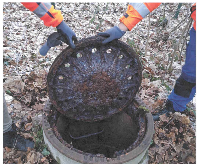
Durch H_2S -Angriff korrodierter Kanaldeckel (Foto: Emscher Wassertechnik, I. Urban)
