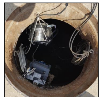
Im Schacht installiertes Probenahmemodul in der Ex-Version
